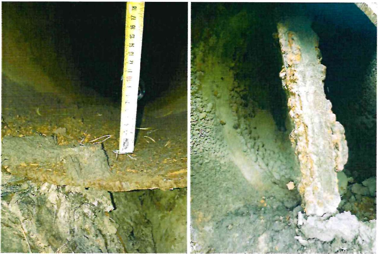
Фото №27,28. Состояние внутренних стенок труб (отложения на стенках, коррозионные повреждения).
