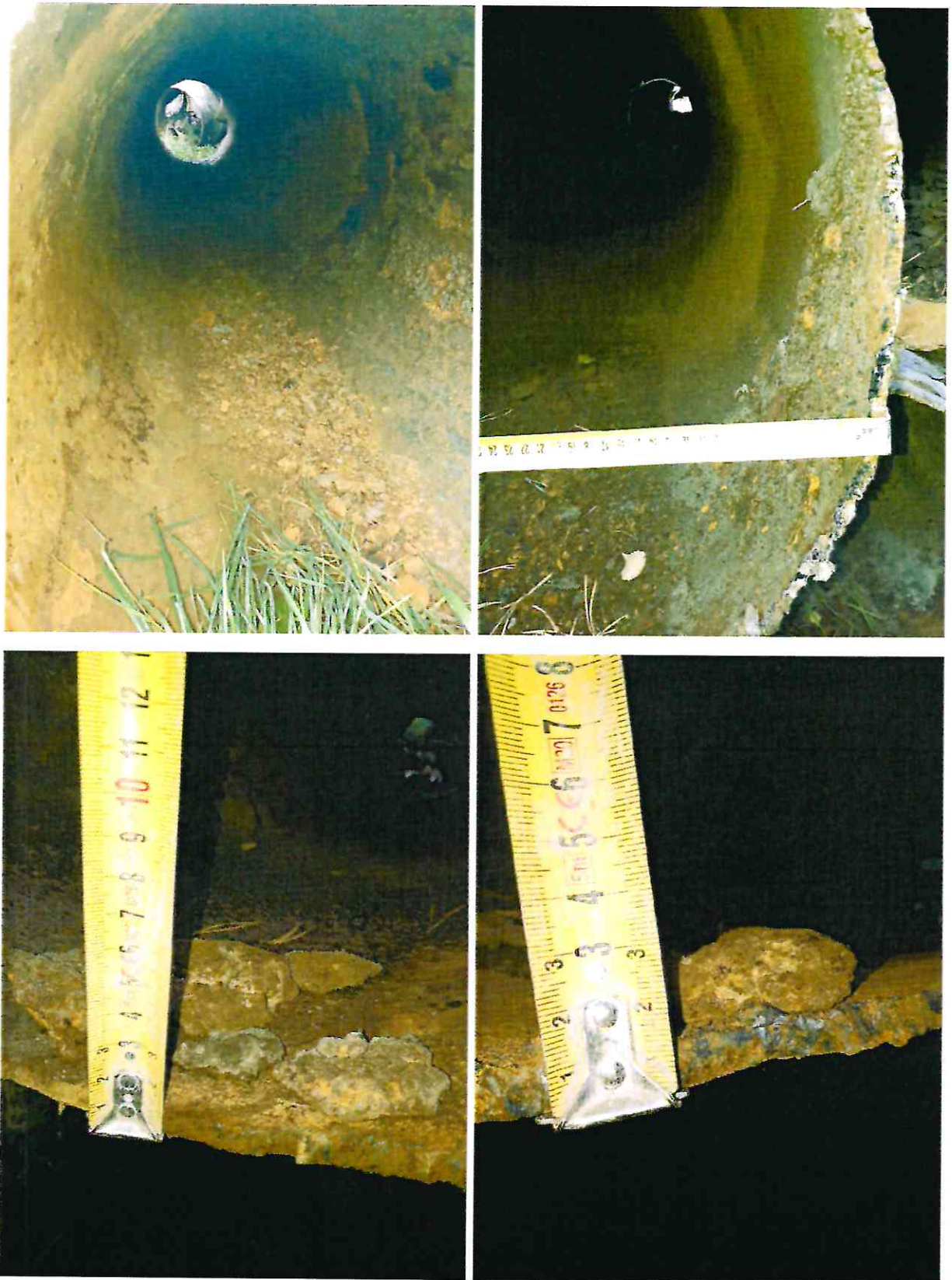
Фото №23-26. Состояние внутренних стенок труб (отложения на стенках, коррозионные повреждения).
