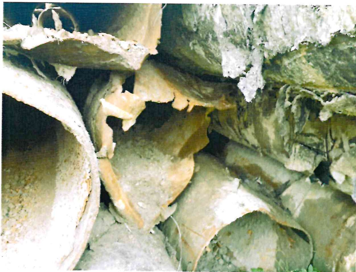
Фото №33,34. Деформация стенок труб.
