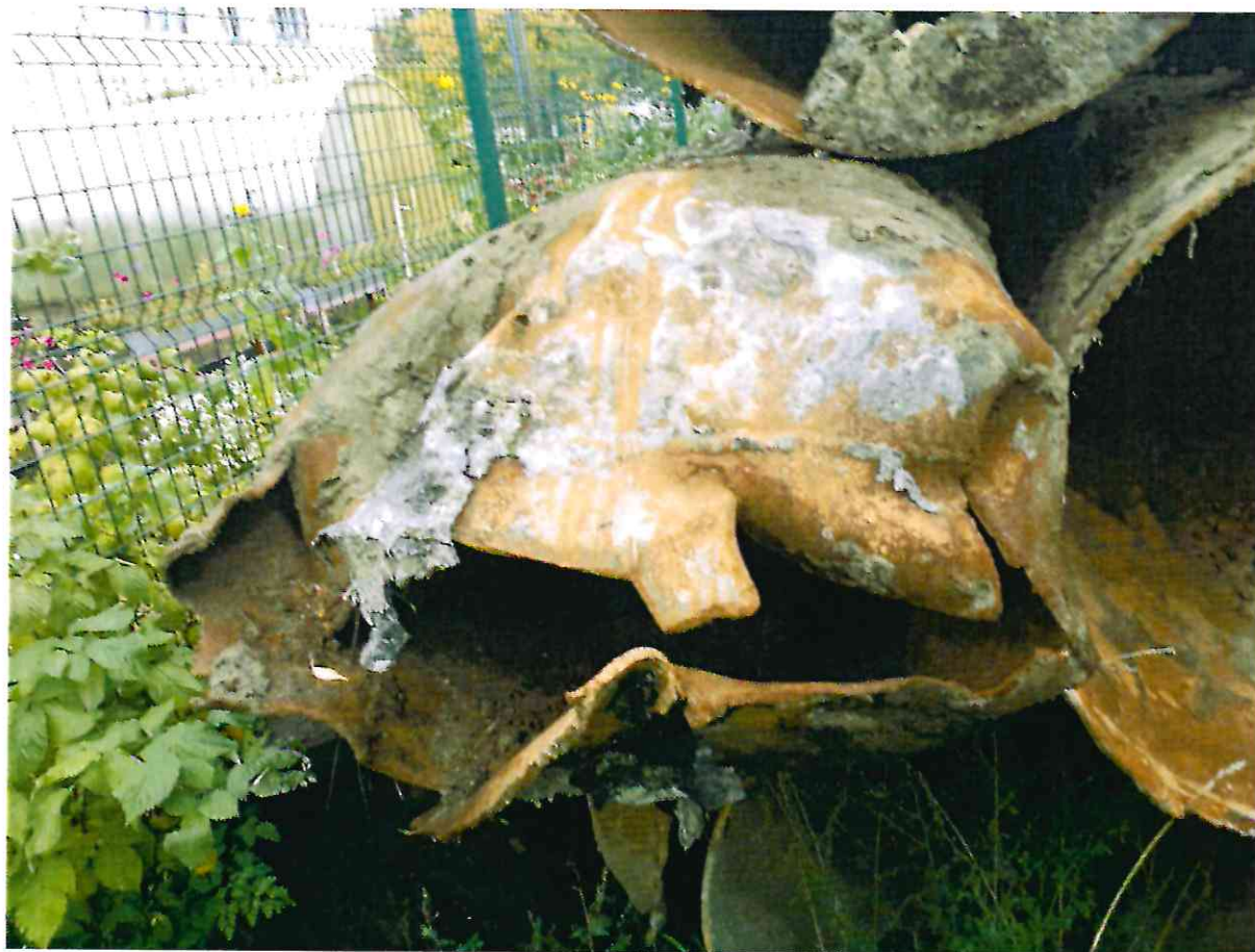
Фото №35,36. Деформация стенок труб.
