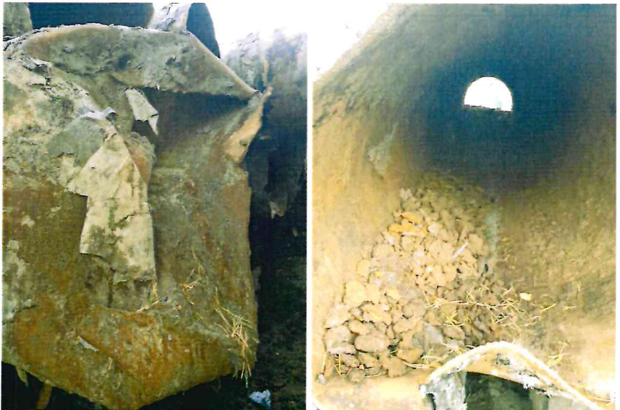
Фото №29,30. Деформация стенок труб.
