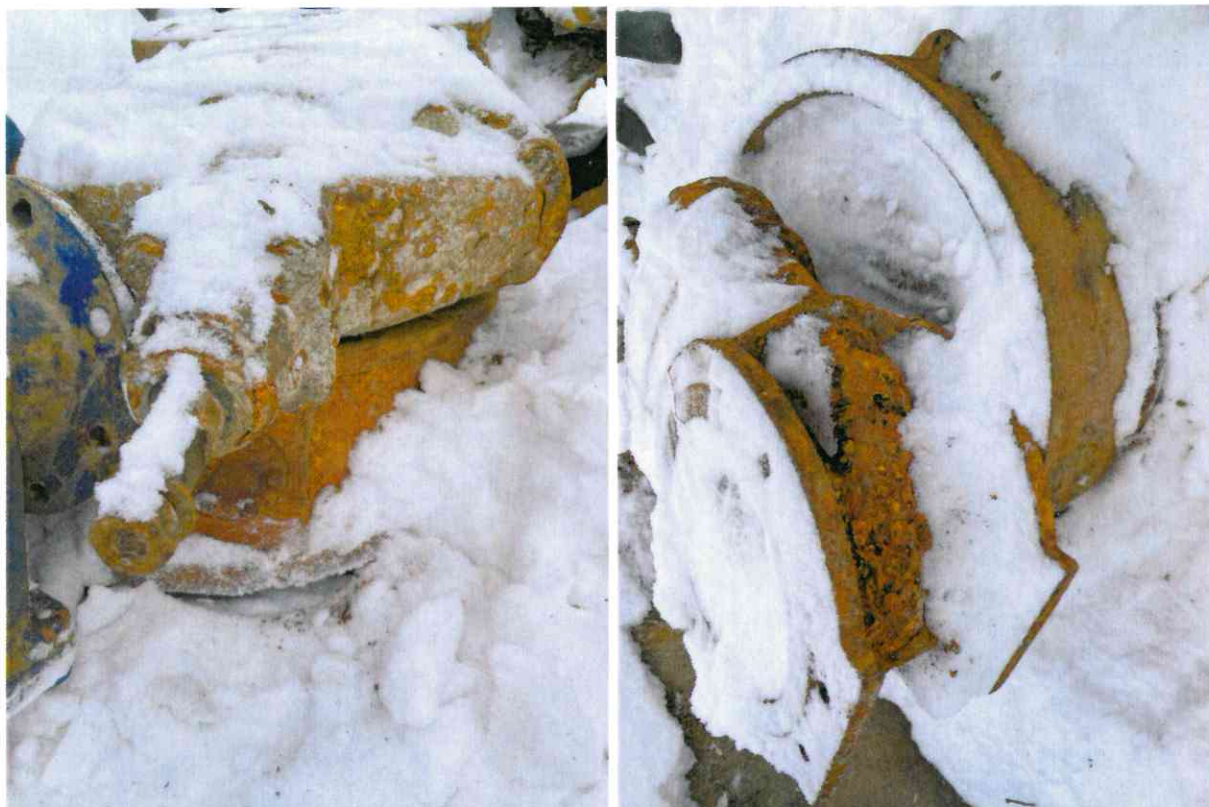
Фото №42,43. Элементы запорной арматуры.
