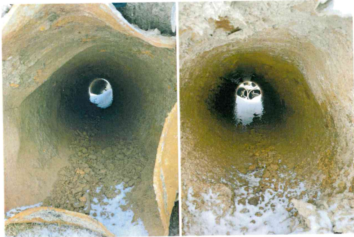
Фото №25,26. Деформация стенок труб.
