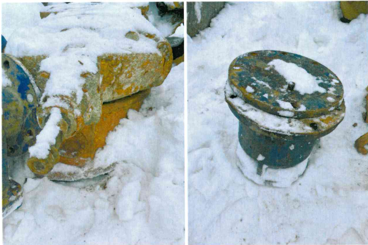
Фото №44,45. Элементы запорной арматуры.
