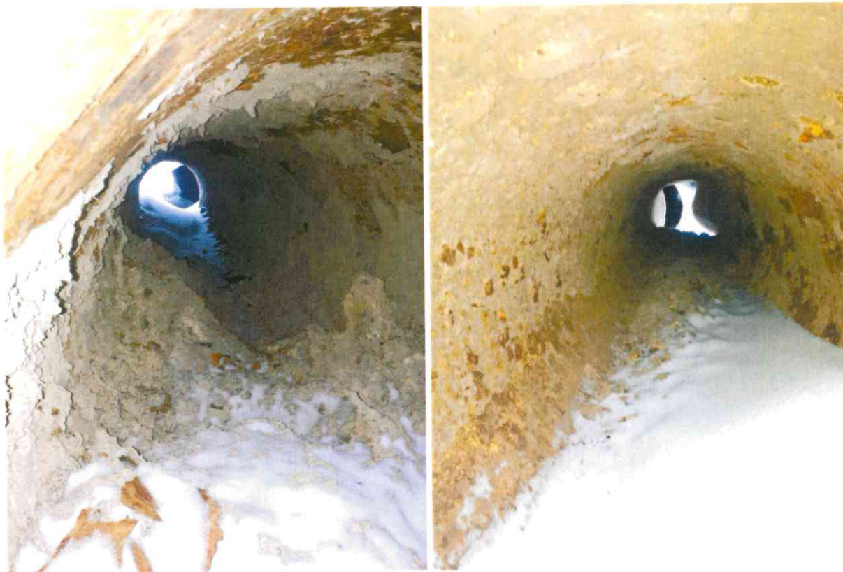
Фото №13,14. Состояние внутренних стенок труб (грунт, отложения на стенках).
