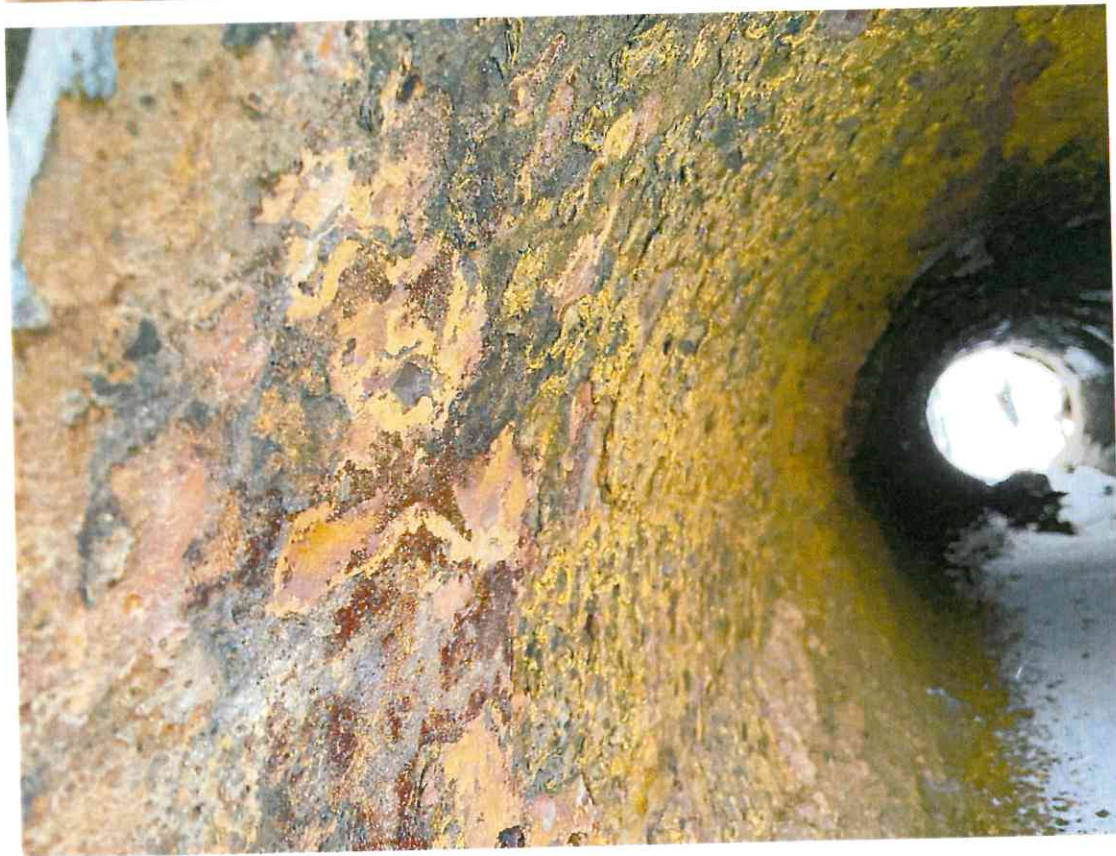
Фото №29,30. Каверны и коррозионные повреждения стенок под отложениями.
