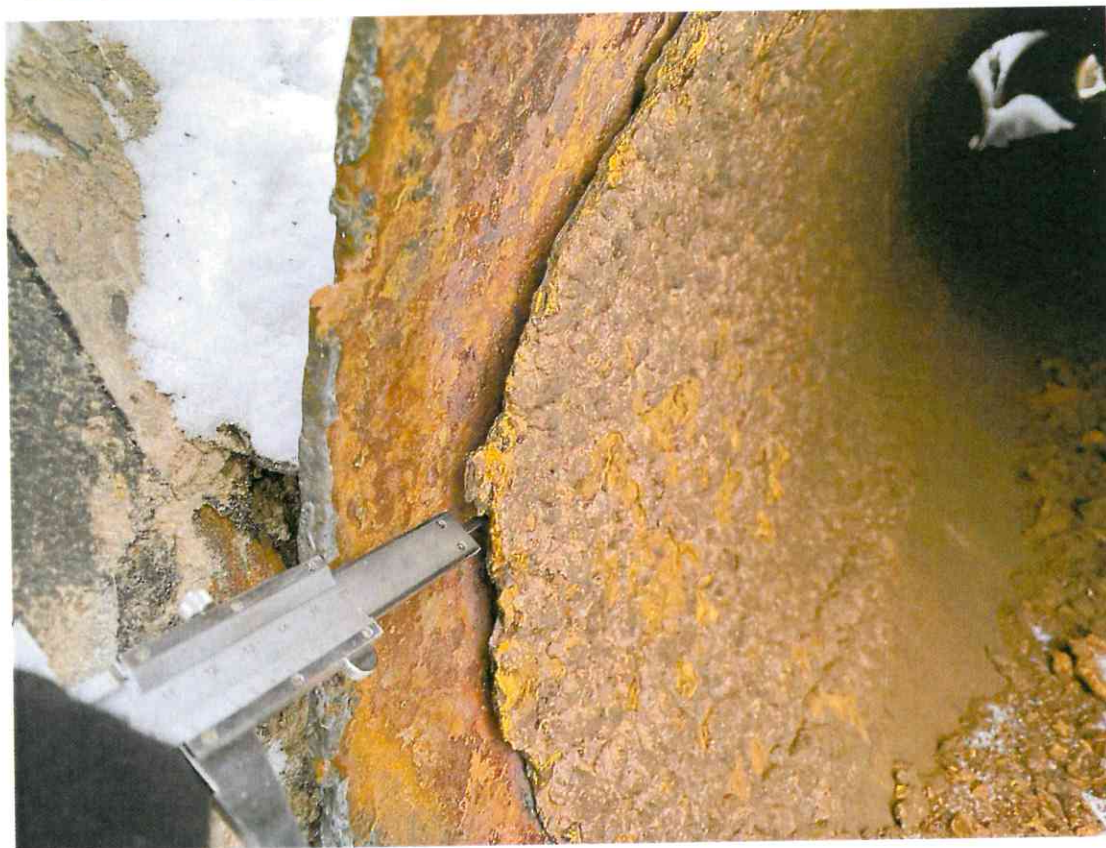
Фото №31,32. Каверны и коррозионные повреждения стенок под отложениями.
