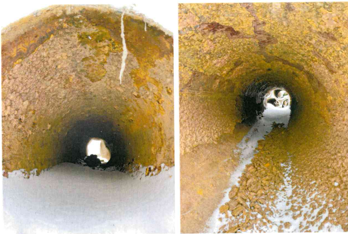
Фото №15,16. Состояние внутренних стенок труб (отложения на стенках, коррозионные повреждения).
