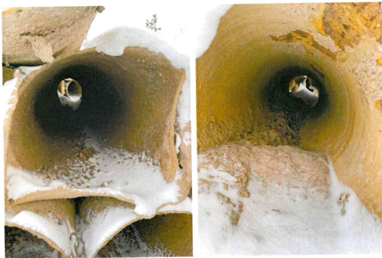
Фото №27,28. Деформация стенок труб.
