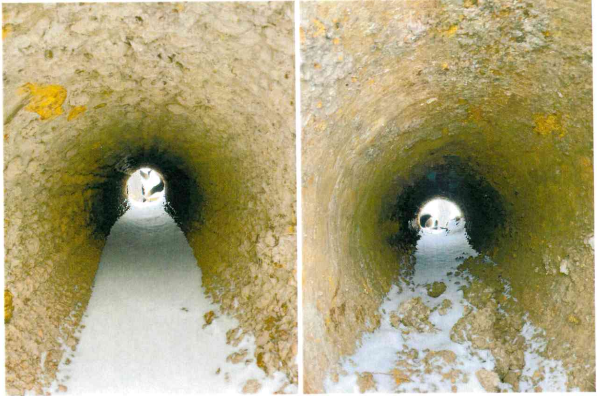
Фото №17,18. Состояние внутренних стенок труб (отложения на стенках, коррозионные повреждения).
